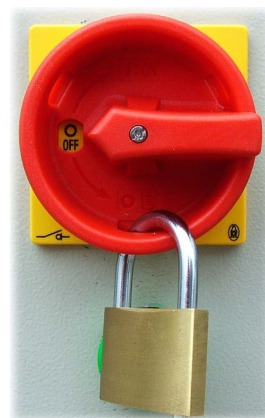
III. 52 Interrupteur principal verrouillé
