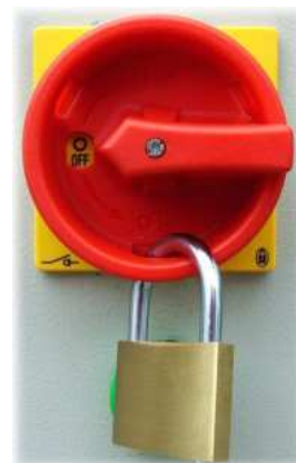
III. 86 Interrupteur principal verrouillé
