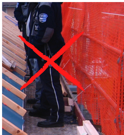
Fig. 5 La police et les autorités d'instruction établissent la cause de l'accident (paroi de protection de couvreur non conforme fixée avec des ligatures de câbles).
