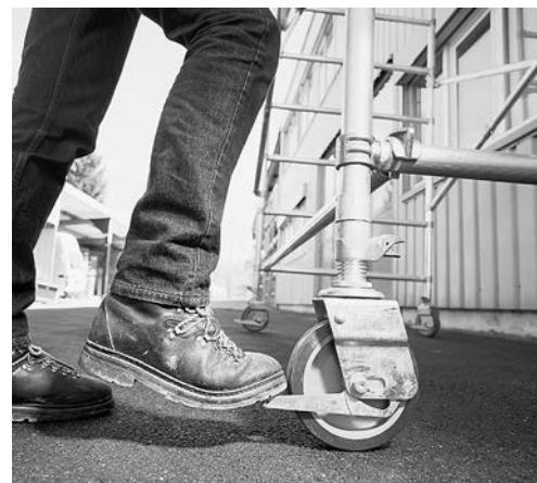
4 Seules des roues bloquées évitent un déplacement involontaire de l'échafaudage roulant.
