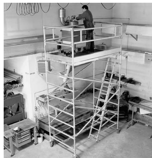
6 L'absence de protection latérale et un plateau défectueux entraînent souvent la chute de personnes.
